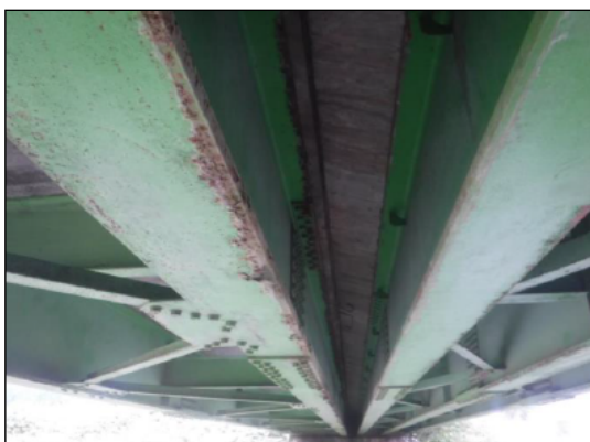
鋼桁の腐食等
