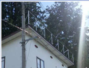
雪庇防止フェンスを兼ねる
