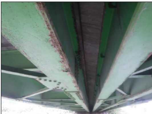
鋼桁の腐食等
