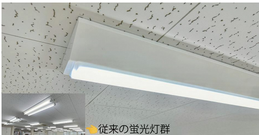
40形2灯器具と明るさ性能同等の1灯LED器具に交換 消費電力は従来品(40W×2)から、 わずか16.3Wに!
