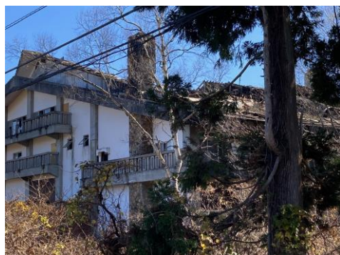
長期間放置された廃屋
